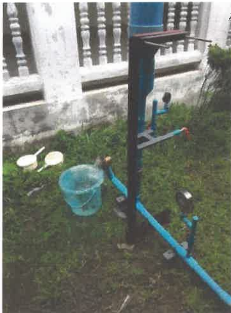
ภาพที่ 2 น้ำที่วาล์วส่งน้ำทิ้ง
